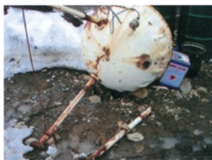
実際に倒れたタンク
